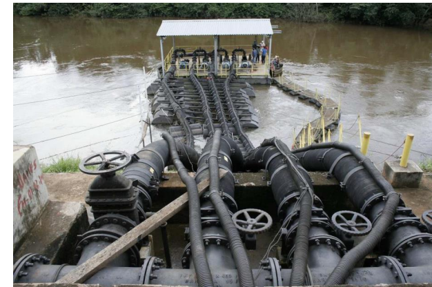
Sistema de captação de água flutuante no rio Parauapebas (PA)
