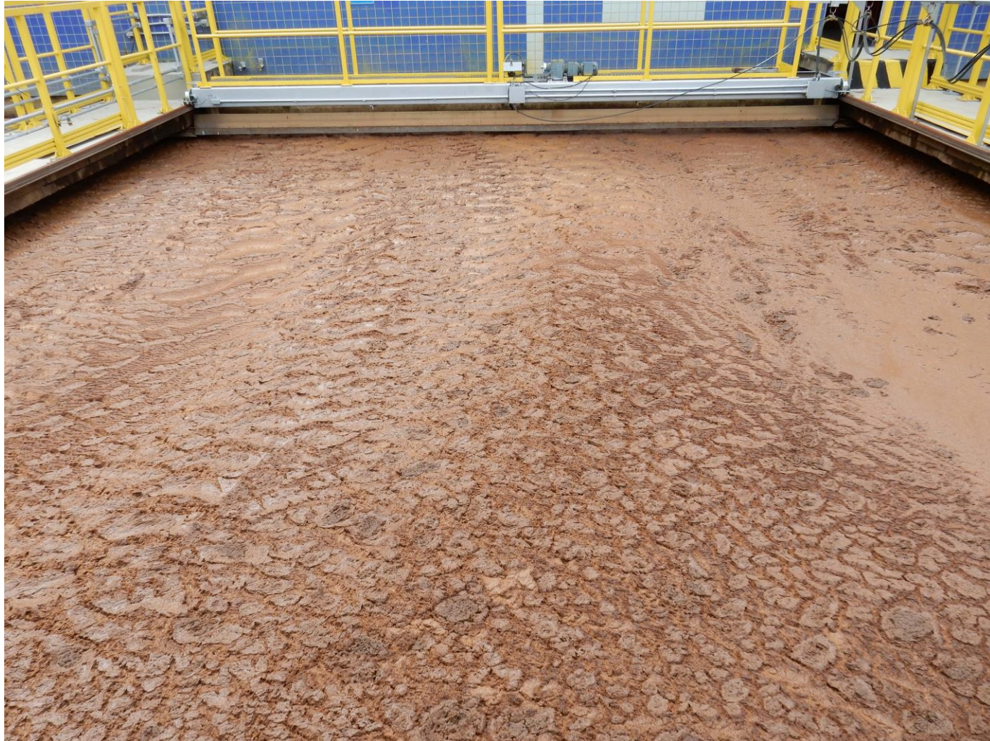
Flotador - Camada de Lodo flotado
